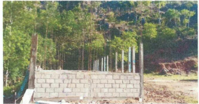
Foto 4: onstrucción abandonada por falta de recurso economico
