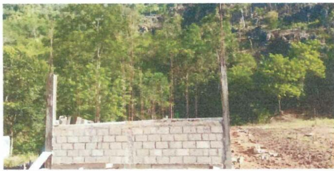
Foto 3: onstrucción abandonada por falta de recurso economico
