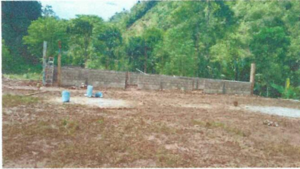
Foto 1: Construcción abandonada por falta de recurso economico
